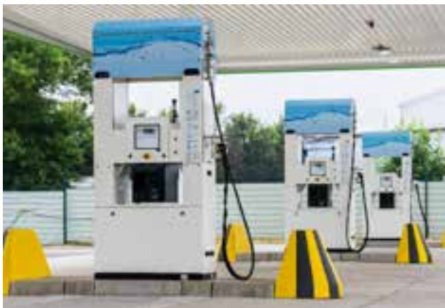
Die Zapfsäulen der Tankstelle können Wasserstoff-Fahrzeuge mit 350 bar (Nutzfahrzeuge) und 700 bar (Pkw) betanken. (Foto: AGR)
