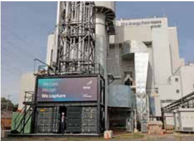
Demonstrationsanlage zur Abscheidung von CO 2 bei EEW in Hannover: Im Falle einer Teilstromentnahme durch die CO 2 -Abtrennung muss es klare Regeln für die Berechnung der Schadstoffkonzentrationen geben. (Foto: EEW)
