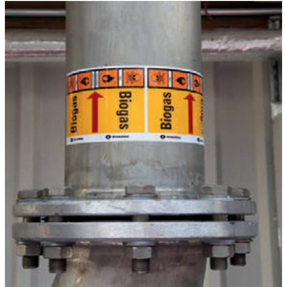
Rohrleitung Biogas, Quelle AWG
