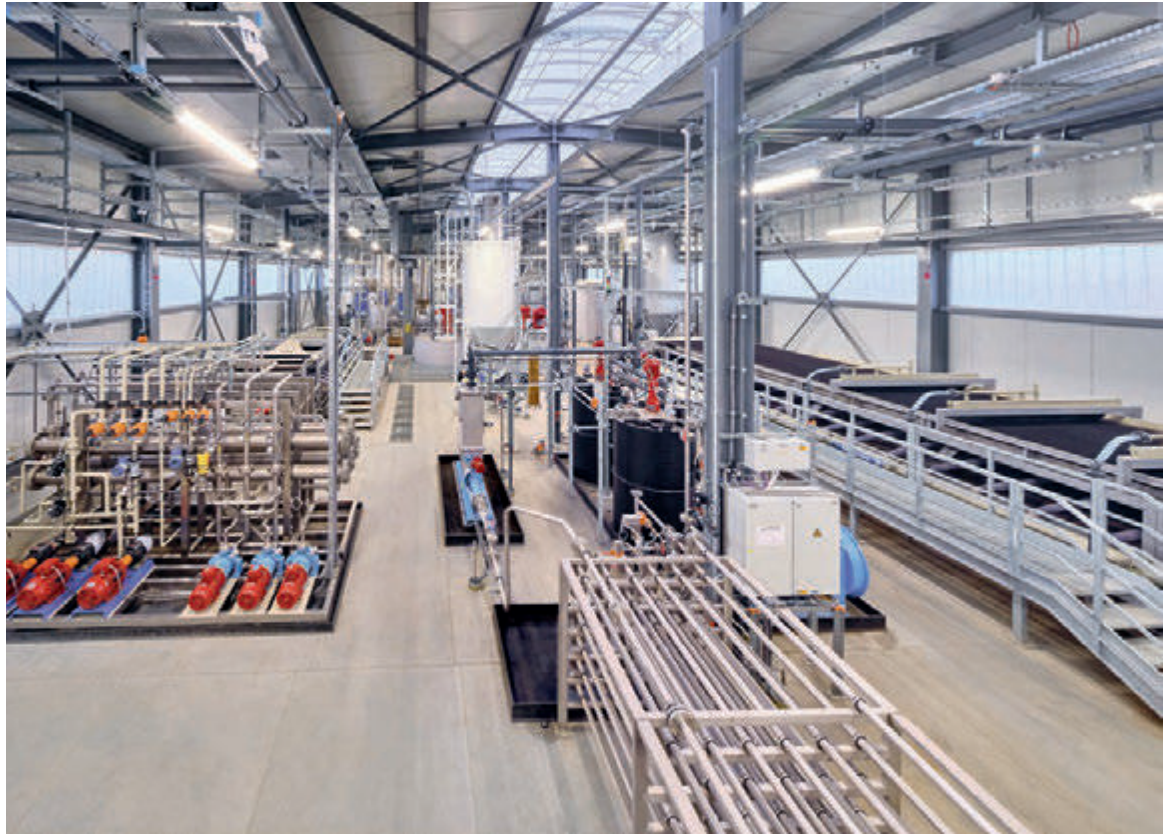
TetraPhos-Anlage Hamburg, Quelle: REMONDIS
