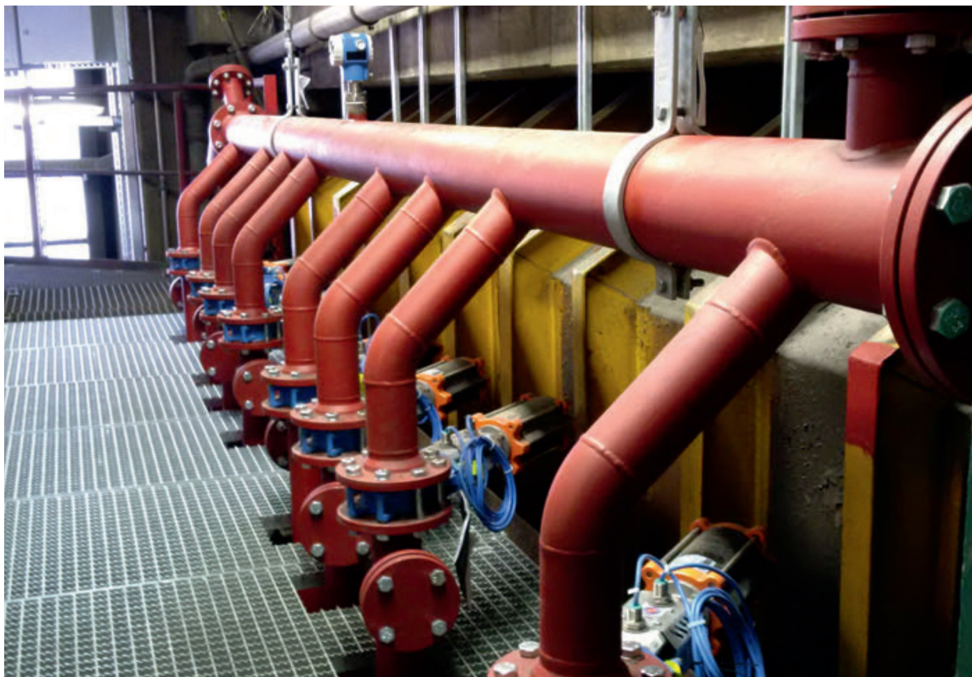
Klärschlamm-Mitverbrennung in der MVA Bielefeld (Klärschlamm-Verteilsammler), Quelle: Stadtwerke Bielefeld GmbH
