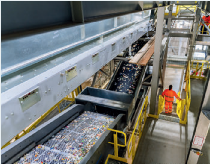
Sortieranlage, Quelle: MEILO GmbH
