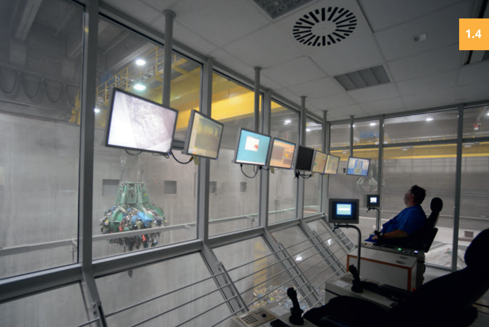
Krankanzel einer MVA: Beschickung der Kessel mit Abfall, Quelle: BSR
