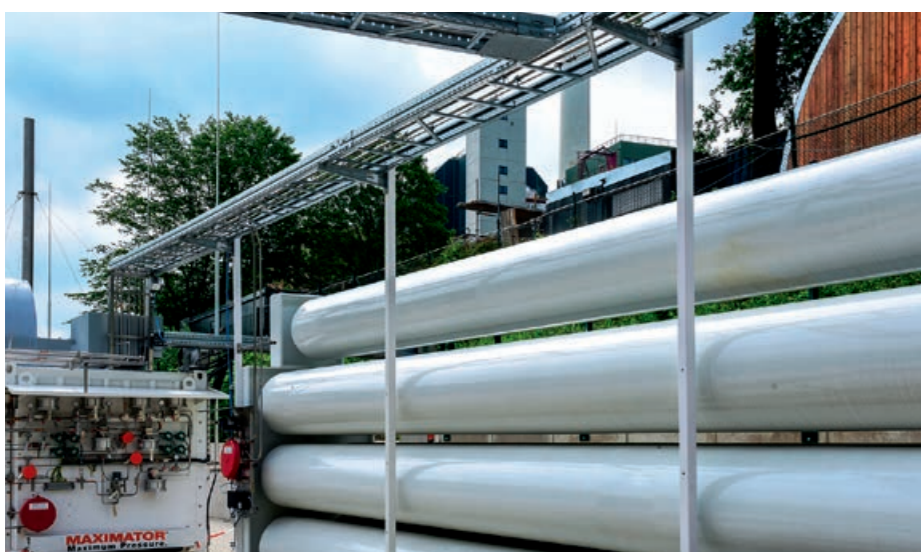
Kurze und sichere Wege: die Wasserstoff-Infrastruktur in unmittelbarer Nähe des Müllheizkraftwerks der AWG in Wuppertal
